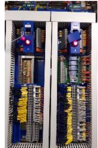
Châssis de relaying après câblage
